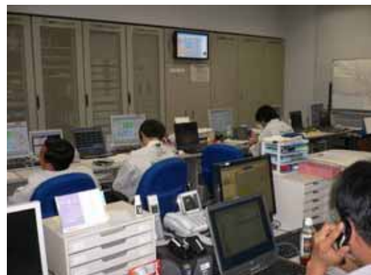
写真 5 マイクログリッド・エネルギー制御システムの設備監視室
