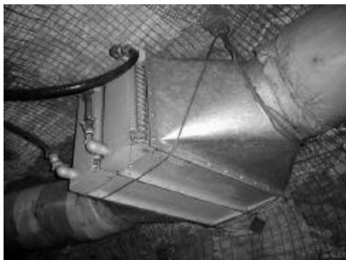
図 4 プレートフィンコイル
